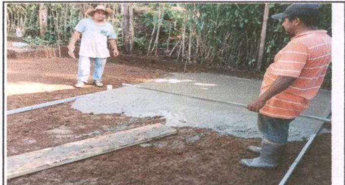
Foto 4: Sustrucción de torta de concreto
